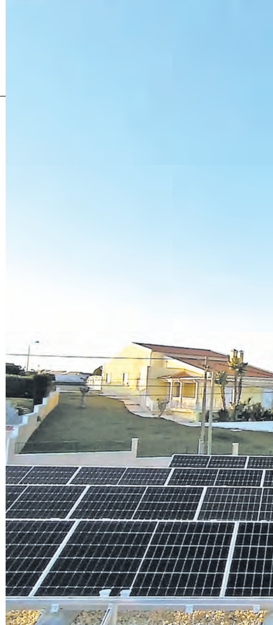
Sistema de painéis fotovoltaicos permite
