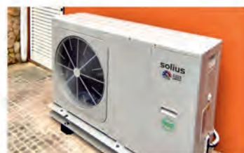
BOMBAS DE CALOR
